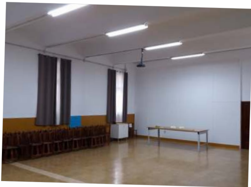
Pinturas en paredes y techos ✓
